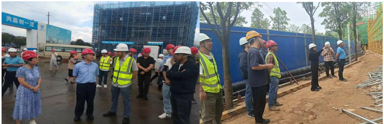
节前配合区政府及政府相关职能部门现场质量安全检查
